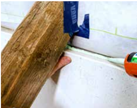
... renovācijas tvaika kontrolei,
